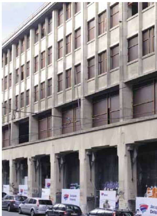
Cet immeuble de bureaux de la rue Royale a fait l'objet de deux permis de démolition/reconstruction. Le premier en 2008, conservant l'affectation bureaux, le second en 2011 de conversion en hôtel.
