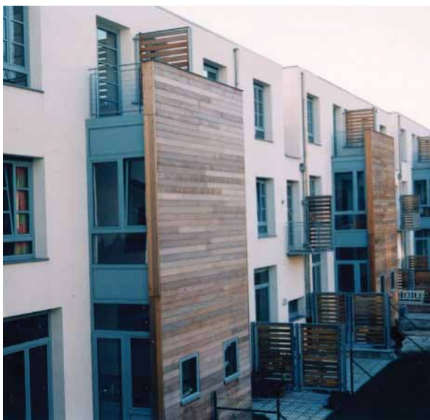
Ensemble de maisons rue Verrept Dekeyser à Molenbeek, visible dans la balade ARCHI-AUDIO (1999-2003). Les enduits n'ont jamais été réceptionnés pour cause de malfaçon. Arch. Pierre BLONDEL
